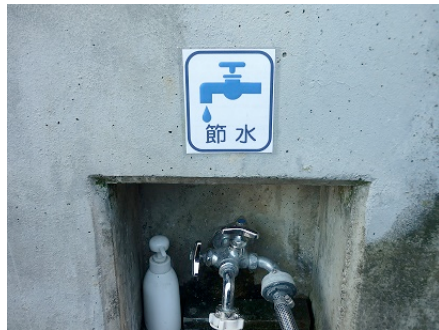
・節水シール貼付け
